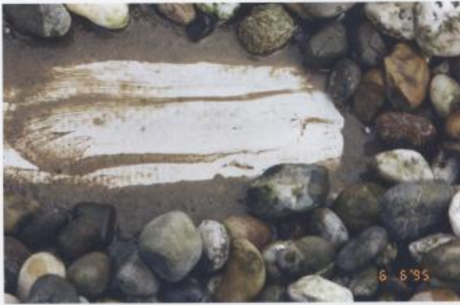
Bild 2. Dauerfeuchte Schmutzablagerungen nach fünf Jahren auf einer Kunststoffbahn mit Kiesschüttung, dadurch beschleunigtes Alterungsverhalten und somit geringere Lebensdauer
