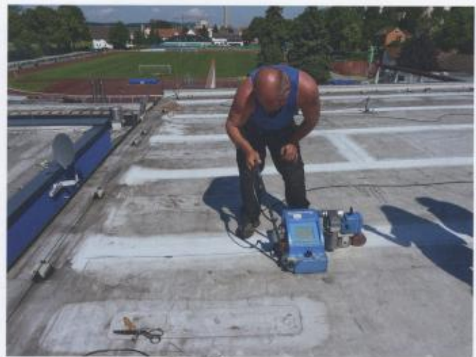
Bild 5. Bei frühzeitiger Feststellung von Verarbeitungsfehlern (bei einer technischen Abnahme der Abdichtung) bleibt oft nur ein Überschweißen der mangelhaften Nahtbereiche mit Bahnenstreifen
