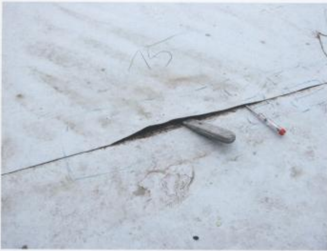
Bild 4. Offene Naht nach 13 Jahren bei einer qualitativ hochwertigen PVC-Bahn, 1,5 mm dick, Einlage: Glasvlies, unter XPS-Umkehrdachdämmung mit 2 % Gefälle verlegt
