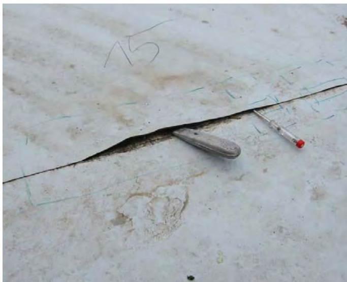
Abbildung 6: Objekt D) Mangelstellen bei der Automatschweißnaht.
