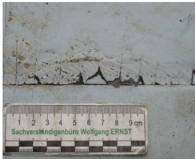
Abbildung 7: Objekt D) Mangelstellen bei den Handschweißnähten.
