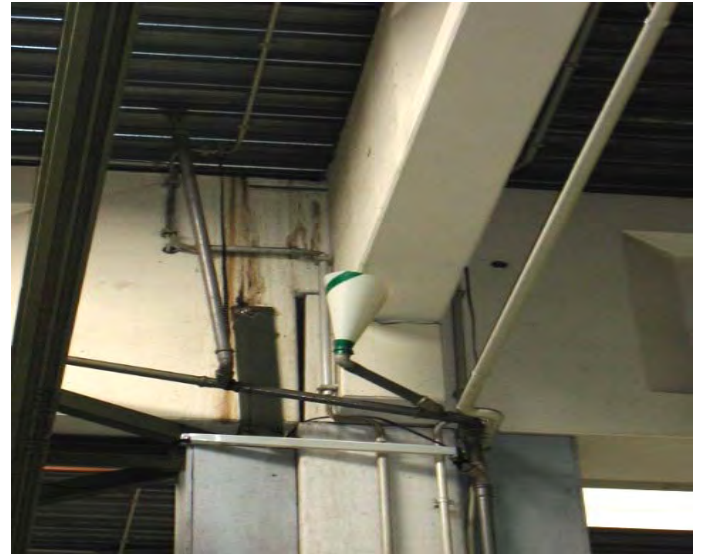
Abbildung 4: Objekt A) Selbsthilfemaßnahmen von Mitarbeitern mit der Absicht den eigenen Arbeitsplatz und die genutzten Maschinen von herabtropfendem Wasser zu schützen.
