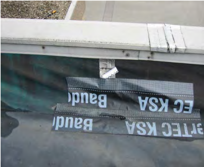
Abbildung 3: Objekt A) Versuch einer Problembekämpfung mit Selbstklebebändern und selbstklebenden Polymerbitumenbahnen auf einer Kunststoffdachbahn (ECB).
